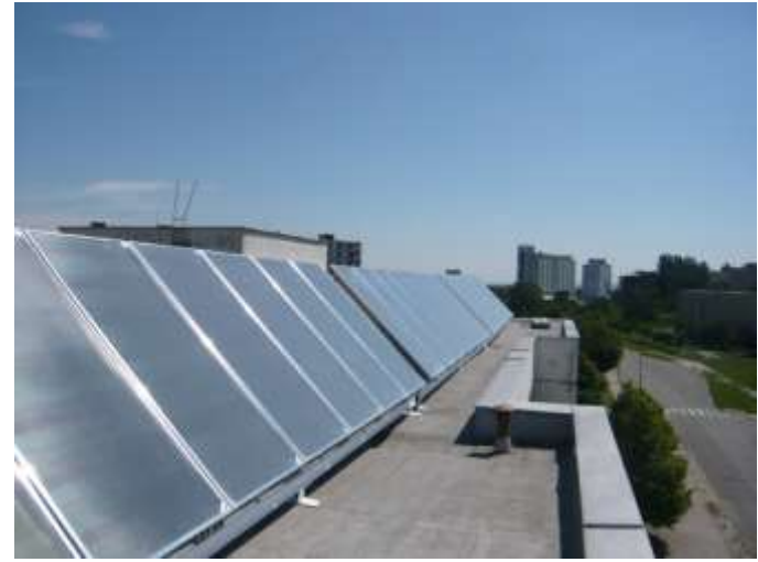
Solární systém na střeše budovy instalovaný roce 2008
