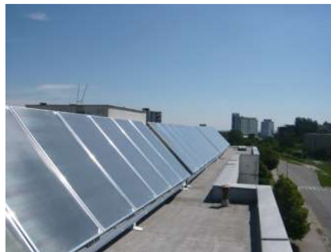
Solární systém na střeše budovy instalovaný roce 2008
