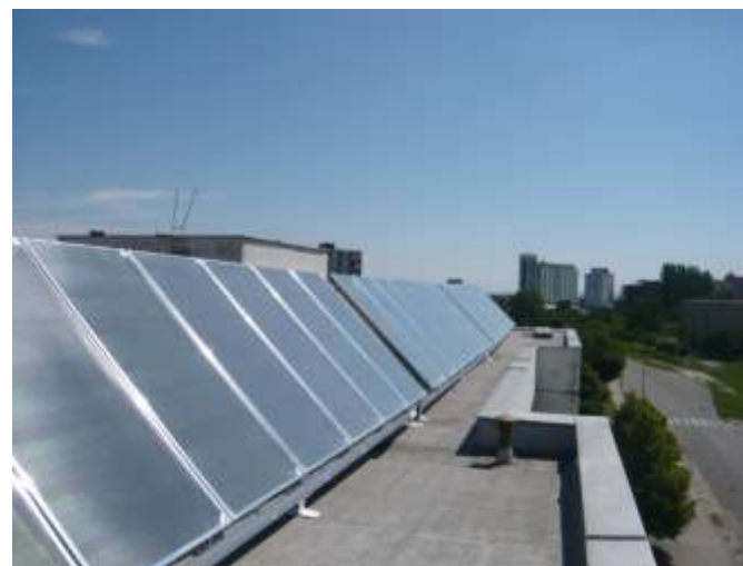
Solární systém na střeše budovy instalovaný roce 2008
